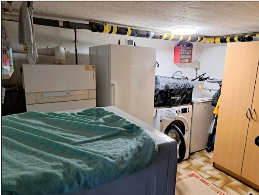
KG Waschen / Heizung
